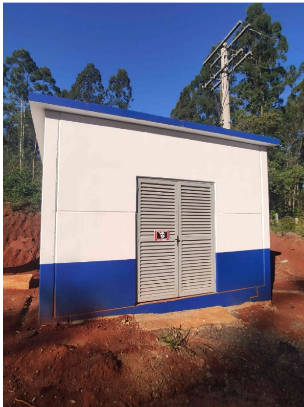
Cubículo de medição externa
