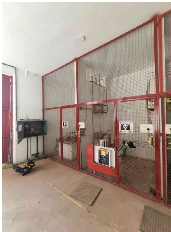
Cubículo de medição interna
