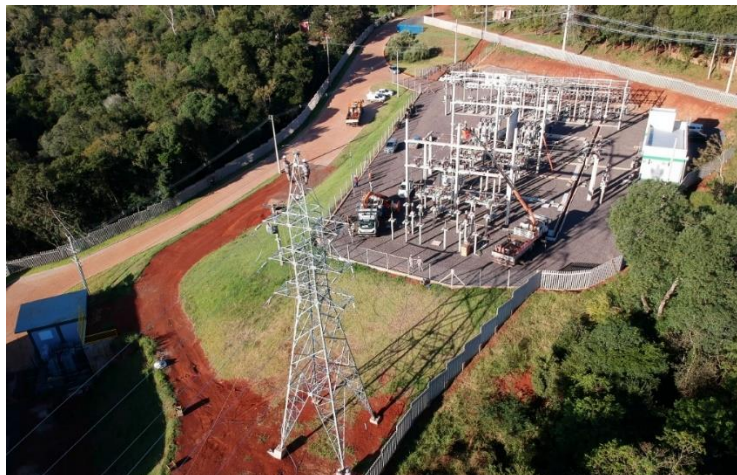
Nova Subestação, construída em Ijuí, ao lado da PCH Ijuí Centenária, também do Grupo Ceriluz.
